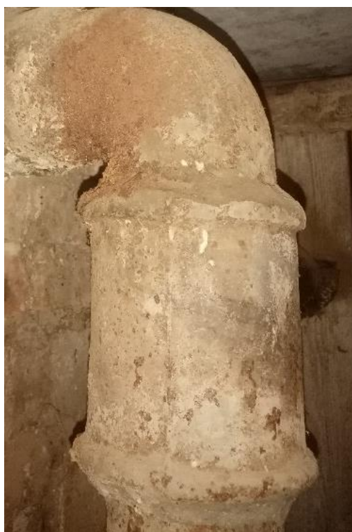
Коррозия чугунного колена (инженерные коммуникации)
