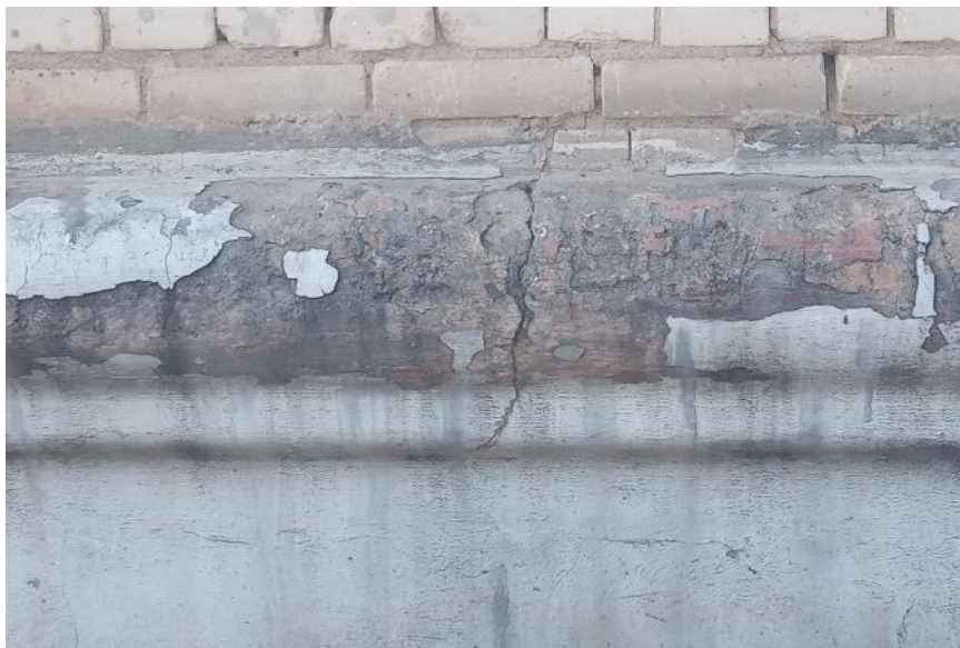
Глубина трещин до 2 мм (длиной 110-135 мм)
