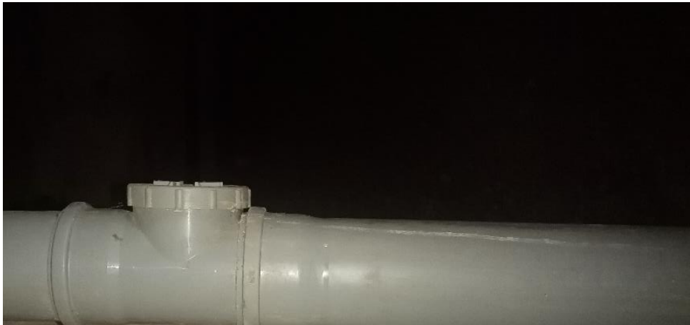
Отсутствие крепёжной ленты на канализационном внутреннем стоковом конректе
