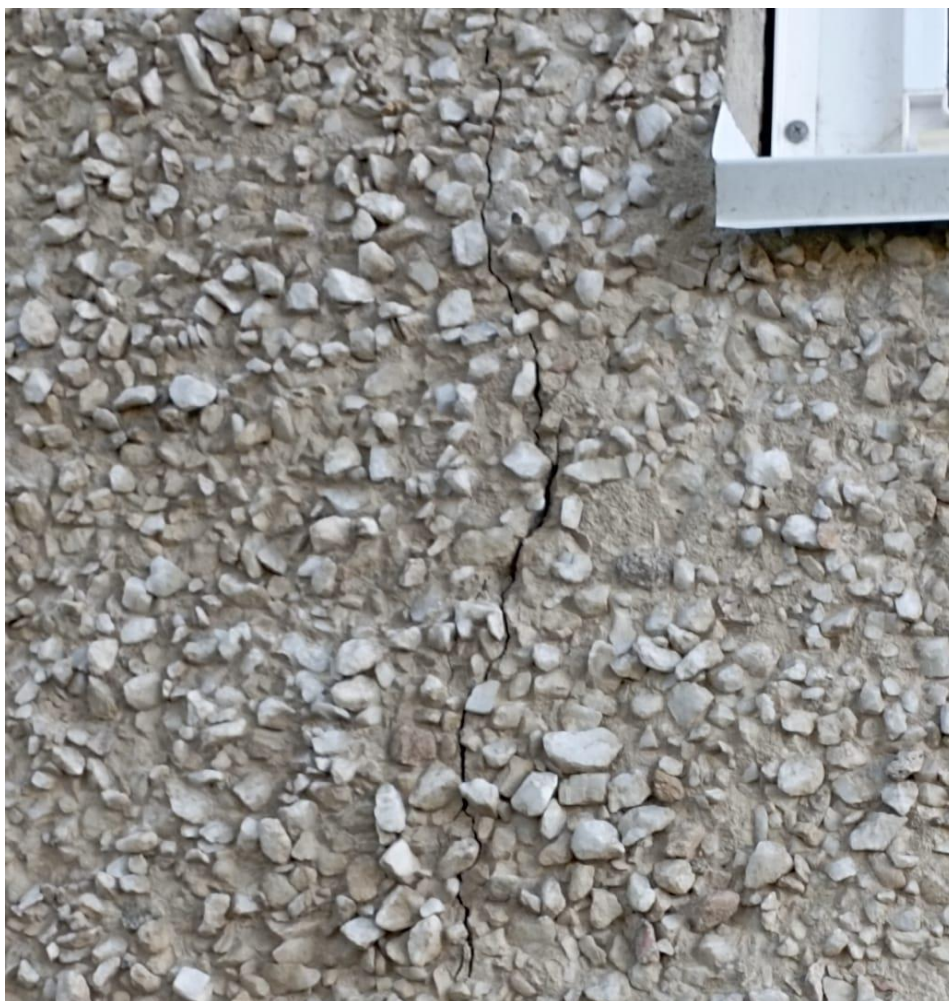
Рис. 2 «Разрушение внешнего покрытия вертикальной несущей стены»
