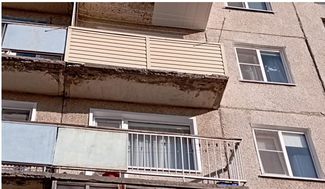
Рис.4 «крупчатое разрушение бетонной плиты с большой нагрузкой на конструкцию при своевольном оформлении продольных перекрытий»
